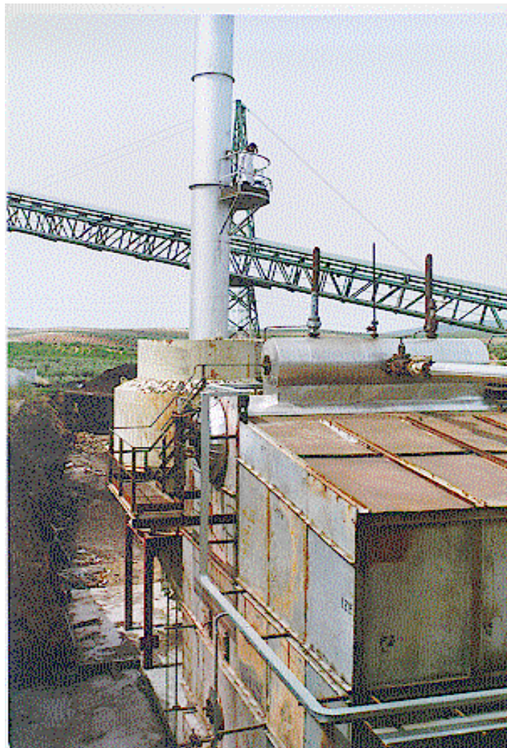
Planta térmica alimentada con hueso de aceituna en la provincia de Córdoba (4,6 MWth)
