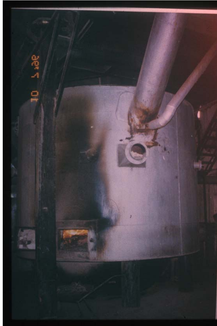
Combustor de biomasa de tecnología ciclónica. 1,1 MW
