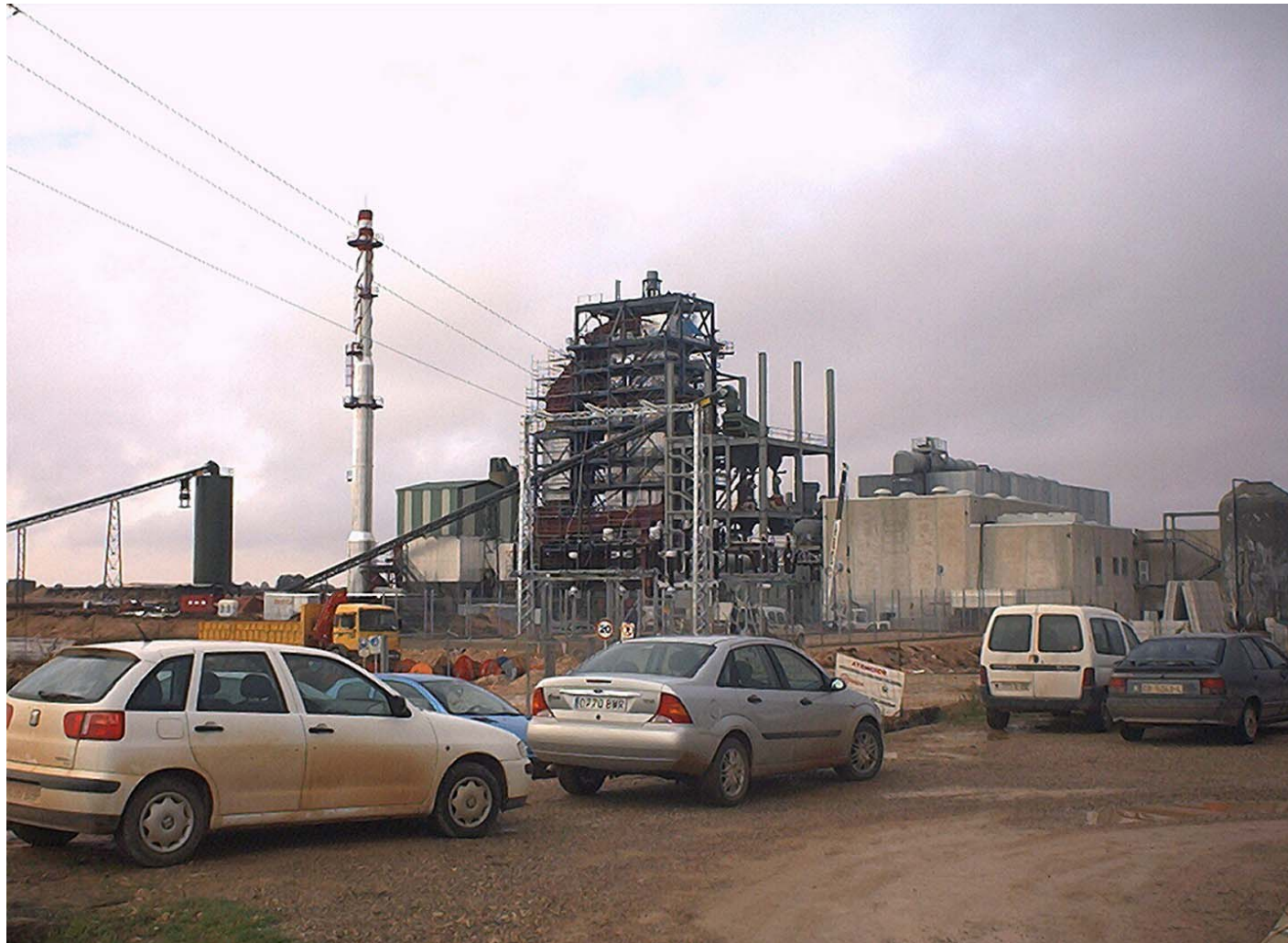
Planta de generación eléctrica con orujillo. Villarta de San Juan (Ciudad Real). 16 MWe . Horno de combustible pulverizado
