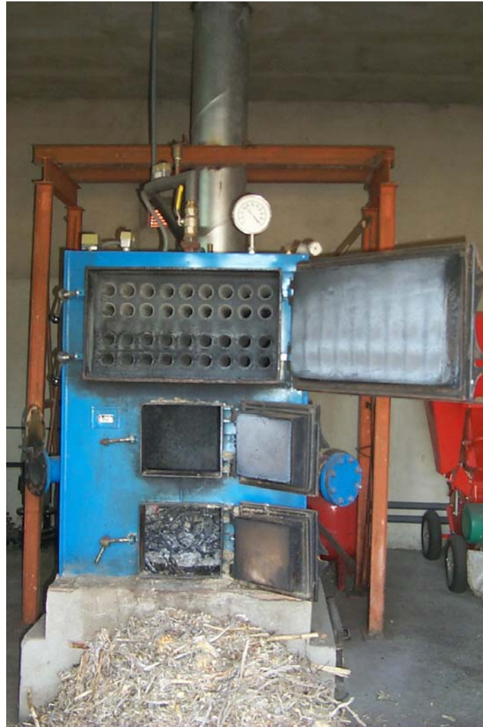
Vista de los tubos de un recuperador de calor en una caldera de biomasa pirotubular
