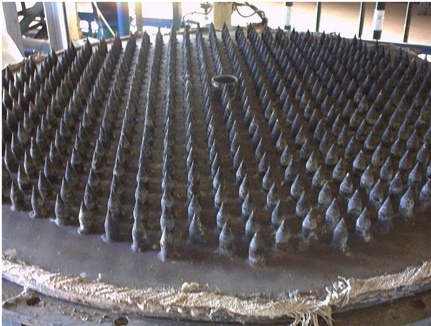
Vista de la placa de distribución de campanas de una planta de combustión de biomasa de lecho fluidizado
